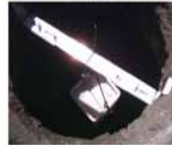
Vista de dosificador # 2 instalado
