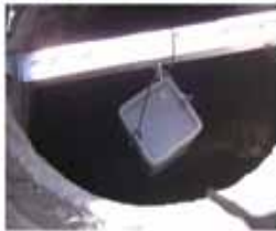
Vista de dosificador # 1 instalado
